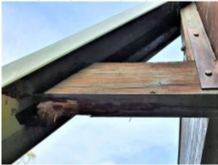
ZANGENKONSTRUKTION DIAGONALE STREBE FEHLT
