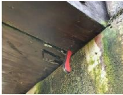
BSH-BINDER AUFLAGERBEREICH VERFAULT UND EINDRÜCKBAR
