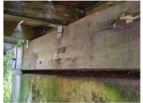
NEBENTRÄGER LÄNGS VERBINDUNGSMITTEL HERAUSGEZOGEN
