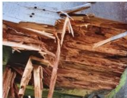
BSH-BALKEN VERFAULT UND SCHÄDLINGSBEFALL
