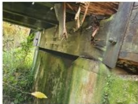
AUFLAGERBALKEN GEBROCHEN UND VERFAULT
